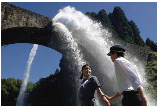
▲地震で亀裂が入り、水漏れが発生した通潤橋
